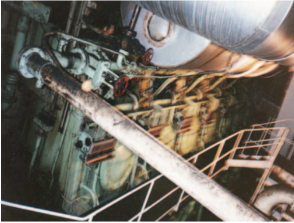
Aspecto de la sala de máquinas principales al momento del achique final.
