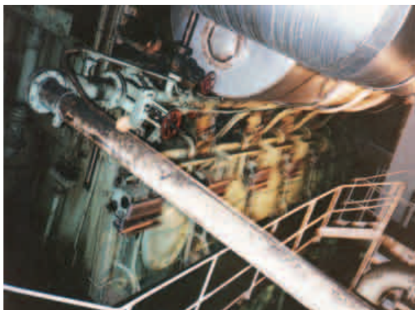
Aspecto de la sala de máquinas principales al momento del achique final.
